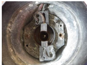
浸水したロウユニット内部
